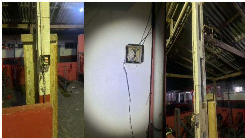
Figura 14 – Quadro geral de energia e as instalações elétricas 1
